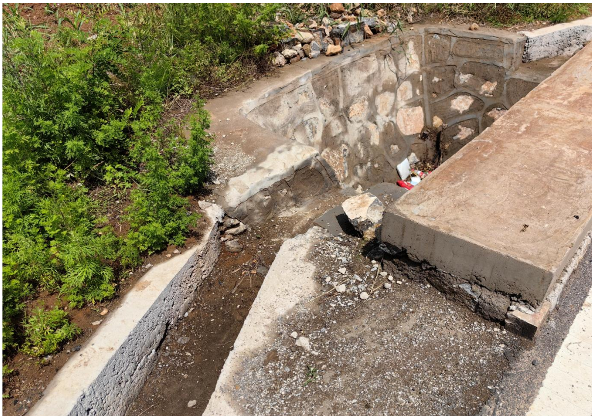
边沟水槽出现裂缝
