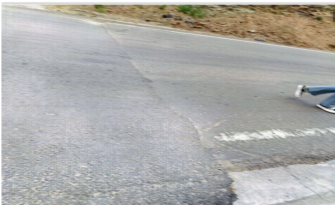
沙坪村-路面裂缝、不均匀下沉
